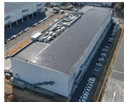
チーズファクトリーの屋上で稼働中の太陽光発電設備
