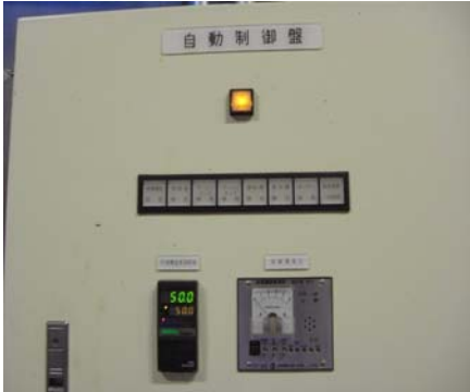
ボイラー貯湯槽の温度変更
